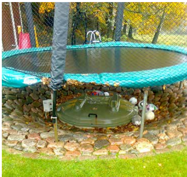
Figur 5. Exempel på ett svårtillgängligt minireningsverk. Foto: Marie H Karlsson, Kungsbacka kommun.
