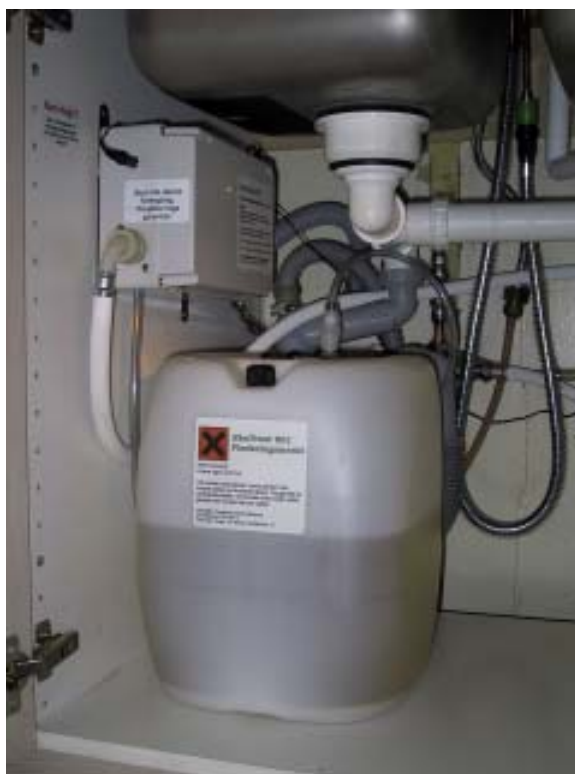
EkoTreat kan placeras t ex under diskbänken. Uppe i bildens vänstra hörn syns styrenheten med kemikaliebehållaren placerad nedanför.
