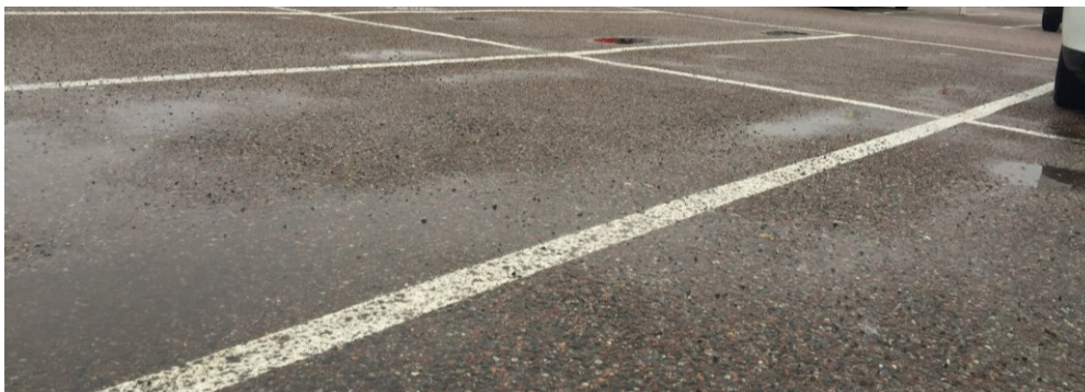
Figur 1. Stående vatten på asfaltsytan vid ett större nederbördstillfälle, före rengöring.
