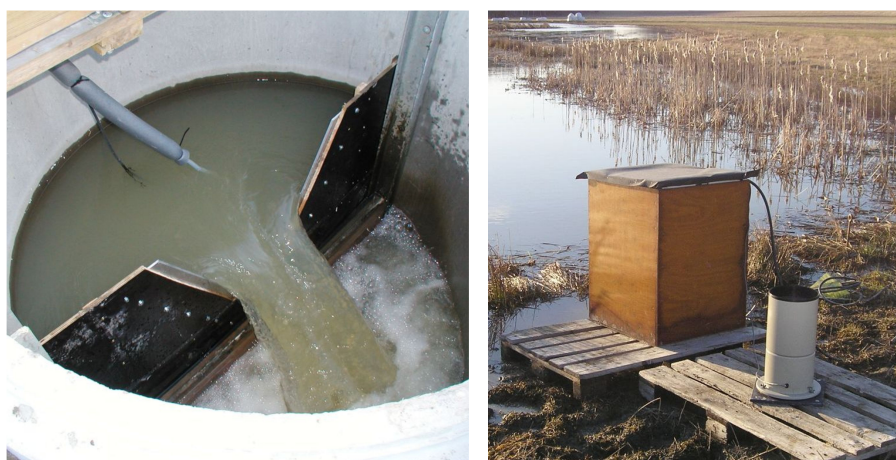
Figur 19. Till vänster det triangulära skibordet i utloppsbrunnen och till höger nederbördsmätaren som är placerad intill provtagningsutrustningen vid inloppet. Foto: Jonas Andersson.
