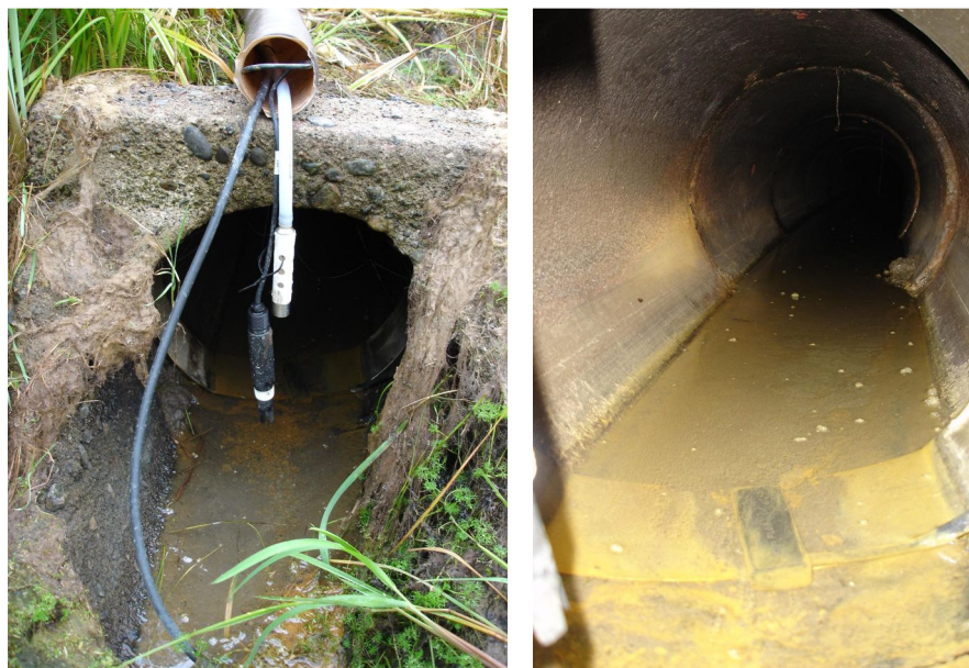
Figur 18. Inkommande betongledning till våtmarken. Normalt är denna helt överdämnd (vid fototillfället var våtmarken nedsänkt för slätter). En temperatur- och pH-givare samt provtagningsslangen har varit placerade rakt framför rörmynningen (bilden till vänster). På botten av trumman syns area/hastighetsgivaren (den lilla svarta dosan på den högra bilden). Foto: Jonas Andersson.
