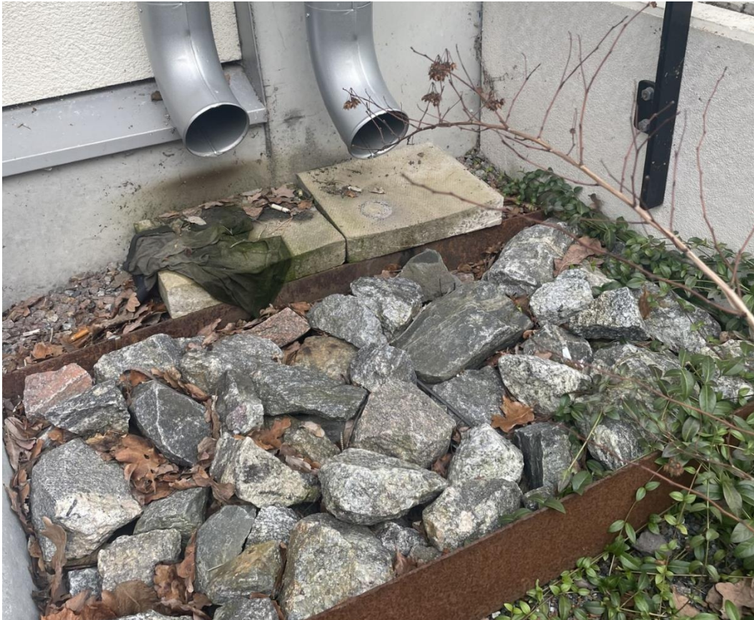
Figur 18: Delvis misslyckad åtgärd med betongplattor under utkastarna (hus ett) för att leda ner vattnet i stenkistan och sedermera ut i planteringen. Vid den vänstra utkastaren kvarstår problemet med att dagvattnet leds ner till dräneringen. (Foto: Hannah Cronblad)
