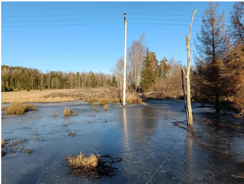
Figur 33. Stolpe med elledning 12 kV som står i vatten vid Gamla Stocksjöns utlopp idag, fältbesök 6 februari 2025, på grund av att bävern byggt dämme i utloppet. Utloppet syns bortanför stolpen i bilden.
